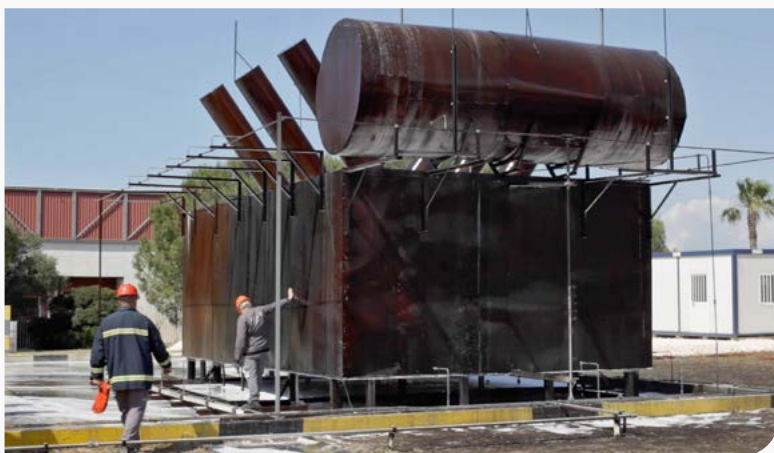
Test temperature trasformatore post spegnimento
