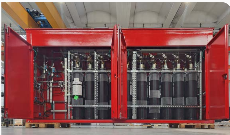
Figura 3 | Package CO 2 per la protezione di una turbina a gas
