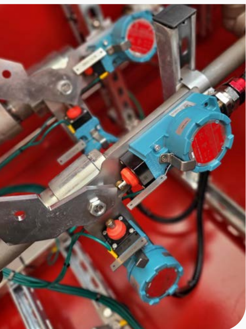
Figura 4 | Dettaglio dei microswitch sulle valvole di intercettazione CO 2
