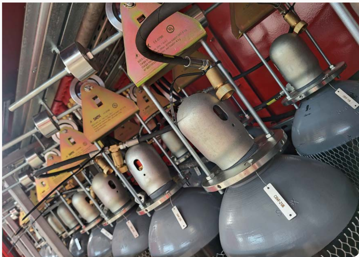
Figura 1 | Impianto CO 2 , con sistema di pesatura delle bombole, UL listed
