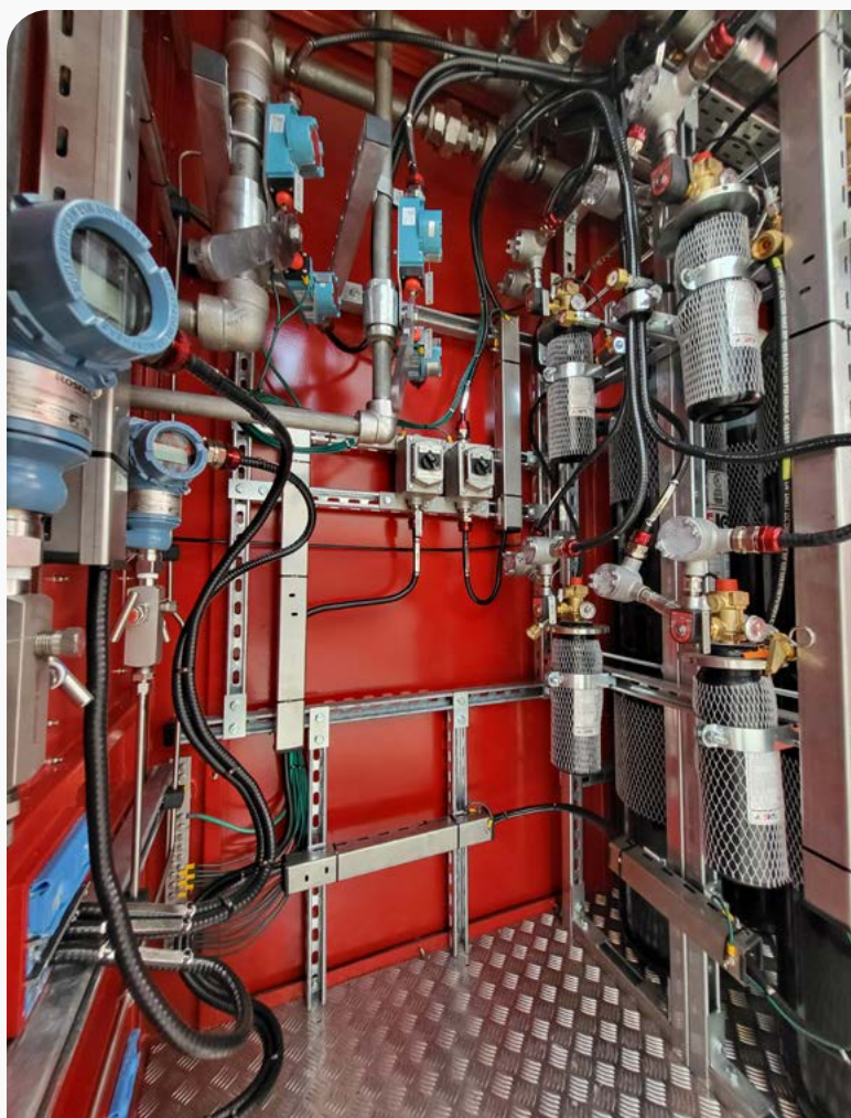
Figura 5 | Un particolare di un sistema CO 2 con bombole pilota e strumentazione ATEX
