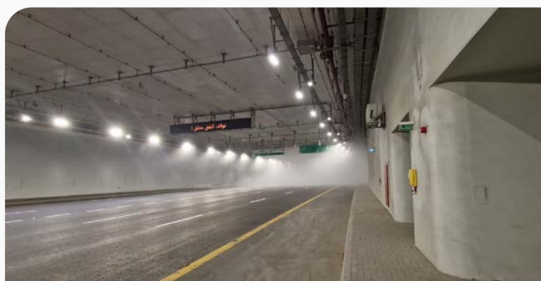
Impianto water mist in erogazione vista 1
