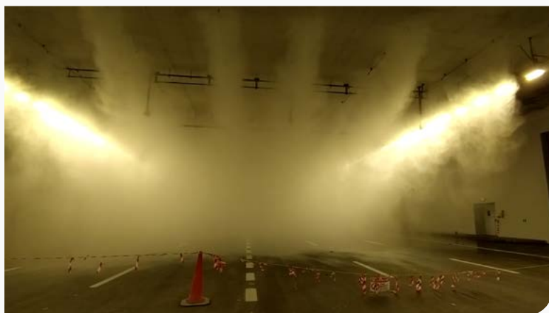
Impianto water mist in erogazione vista 2
