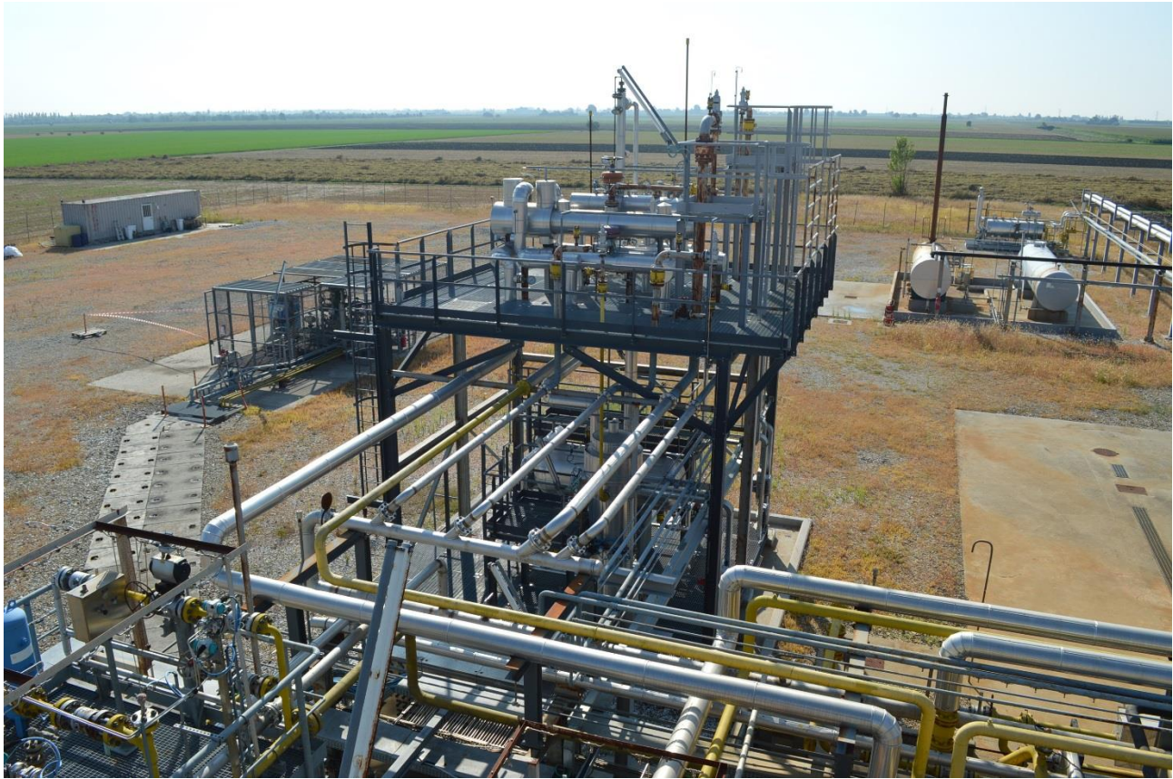
Figura 1: Centrale Gas “Sillaro”
